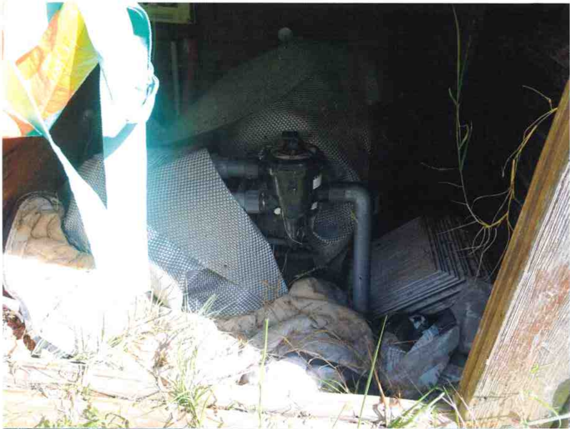
La piscine et sa pompe :
